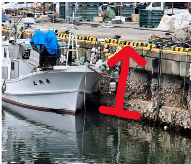
写真8 輪島港の隆起現場
