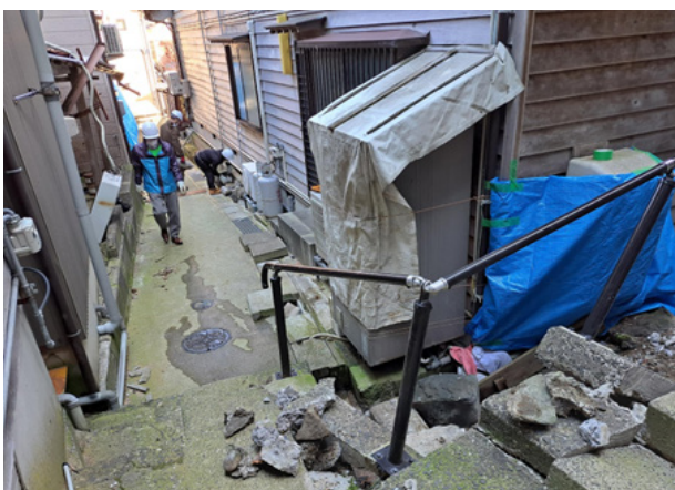
写真18 輪島市の港近く自宅の上下水道管周りの整頓
