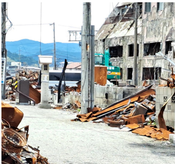
写真14 輪島朝市大火現場での公費解体開始
