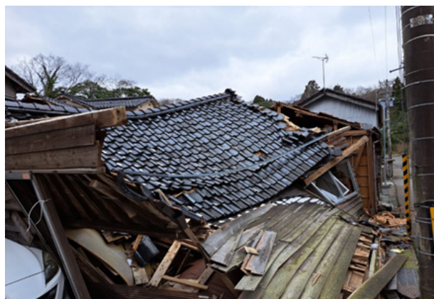
写真2 地震で倒壊された木造住宅
